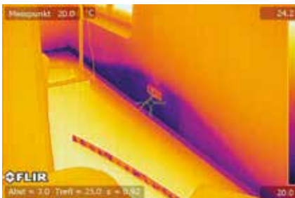
An diesem Fall von Wasserschaden lässt sich leicht der Vorteil der Bild-im-Bild-Funktion verdeutlichen, denn der Kunde kann ziemlich einfach erkennen, welchen Bereich die Wärmebildkamera gerade untersucht, was mit einem Wärmebild allein viel schwieriger wäre.
