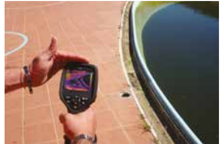
Die FLIR Wärmebildkamera konnte die undichten Stellen eindeutig lokalisieren.
