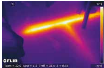
Dieses Wärmebild zeigt, wo die Warmwasserleitung im Boden verlegt wurde.
