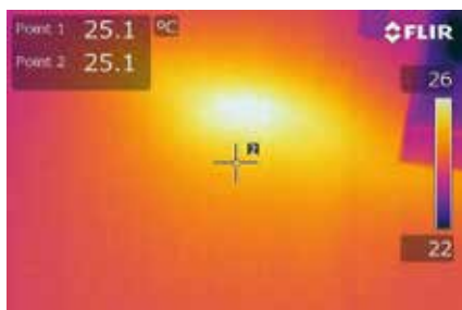
Dieses Warmwasserleck ist im Wärmebild eindeutig zu erkennen.
