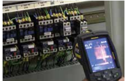
Untersuchung einer Sicherung in einem elektrischen Schaltschrank
