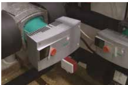
Wärme- und Tageslichtbild einer elektrischen Wasserpumpe.
