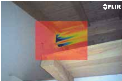
Luftundichtigkeit während der Inspektion mit dem Differenzdruckverfahren, Bild-im-Bild-Darstellung
