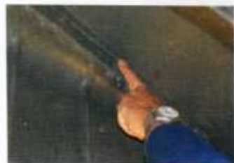
An den Kotflügel-Schraubkanten kann sich Feuchtigkeit sammeln und Rost bilden.
