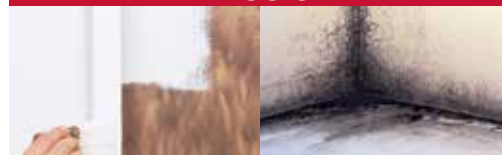
Brandschaden Muffiger Schimmel und Mehltau
